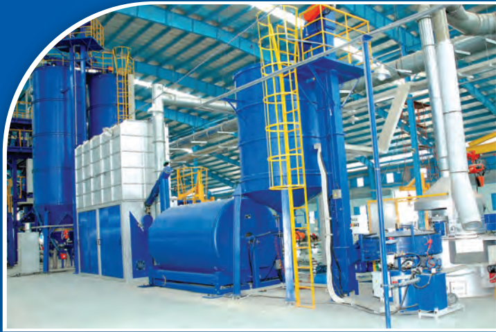
Hệ thống sản xuất bột chì (Ý) / Lead Oxide System (Italy)
